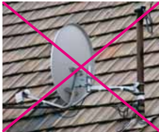
Montáž na kotvu elektrického napätia (nebezpečné, proti predpisom).
