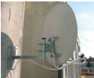
Konzola je správne prichytená a káble sú upevnené.
